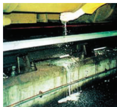
Öliges feuchtes Kondensat dringt in das Druckluftsystem ein, wenn es nicht wirksam entfernt wird.
